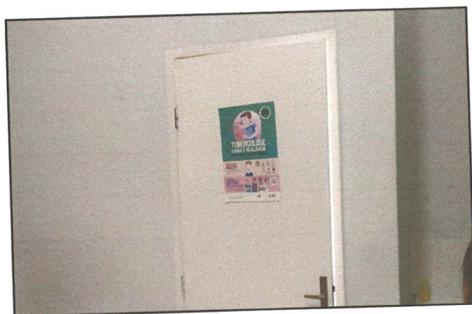
FIGURA 05 - Salas sem placas de identificação
