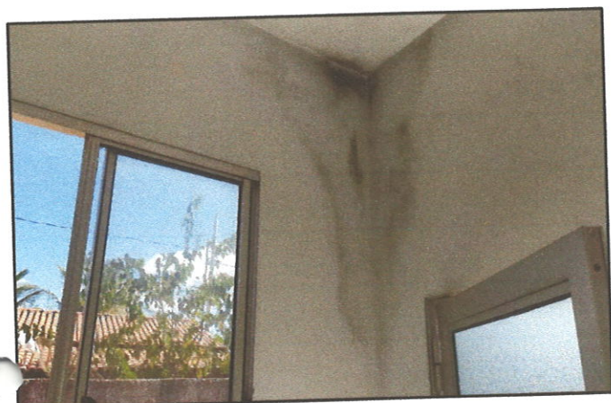
FIGURA 03 - Manchas nas paredes
